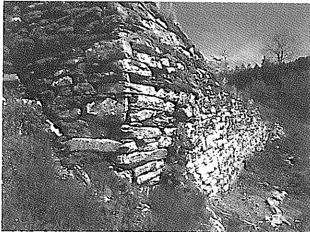
11. Gartenmauern aus Naturstein südlich vom Kloster, die nach Rodungsarbeiten im Frühjahr 2014 entdeckt wurden: bauliche Elemente des historischen Terrassengartens.
