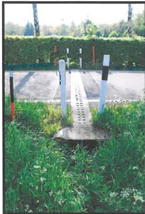
Abb. System ACO Pro in Monschau Eschbachstraße(Quelle: D. Liebert)
