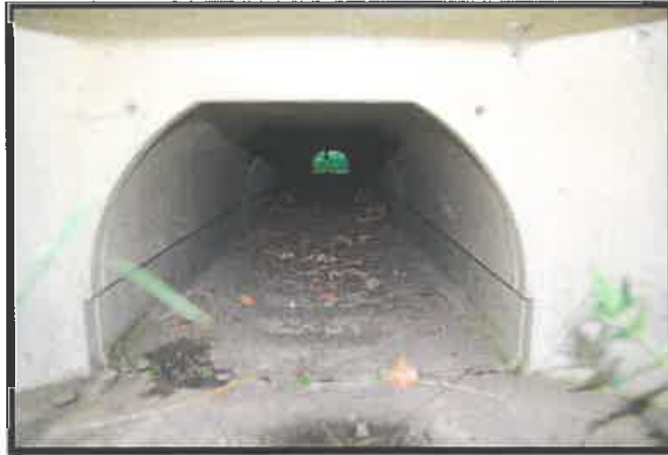
Abb. System ACO Pro in Monschau Eschbachstraße(Quelle: D. Liebert)
